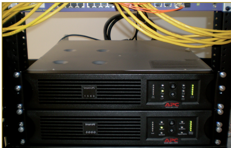
Slika 2.9. Kontinuirani UPS sustavi
